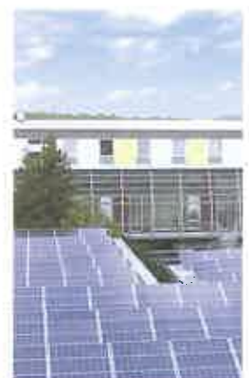
Photovoltaikanlage der Landessportschule – hier wird Albstrom produziert.
